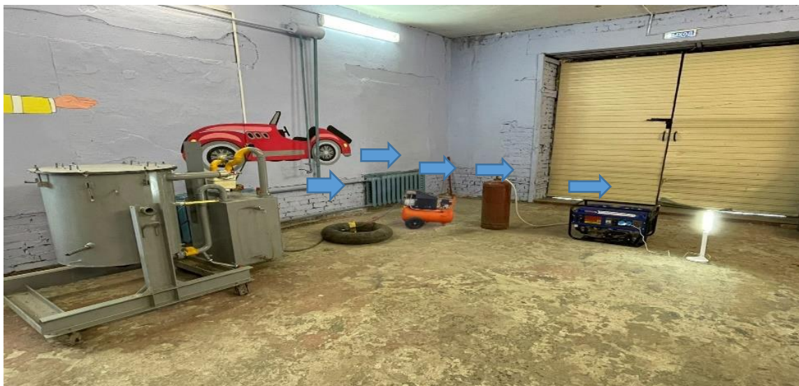
Рисунок 2 – Общий вид пилотной когенерационной линии:
